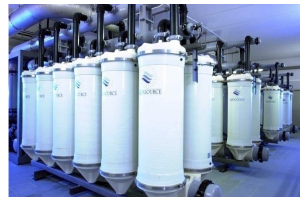
Station d'eau potable (24 000 m 3 /jour) de ROUEN avec 4*24 modules de 125 m 2 de surface. Mise en service 2000 (photo www.aquasource.fr )
